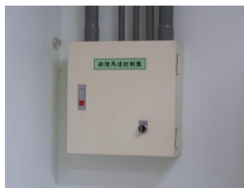
強制排煙系統
