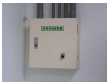
強制排煙系統
